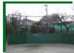
香川小のバックネットをグリーンスタースで改装工事を行い2/5に完成しました。
